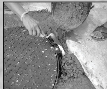
เทคอนกรีต อย่าให้คอนกรีตเข้าไปบริเวณบานพับ (ในกรณีรุ่น TRP)
